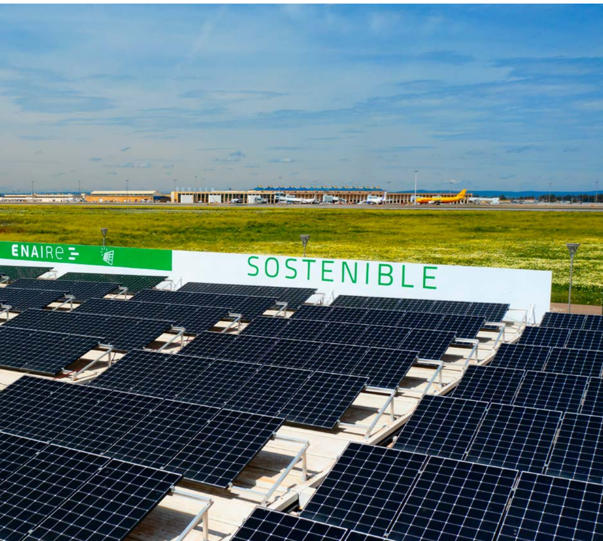
Paneles solares en Sevilla.
