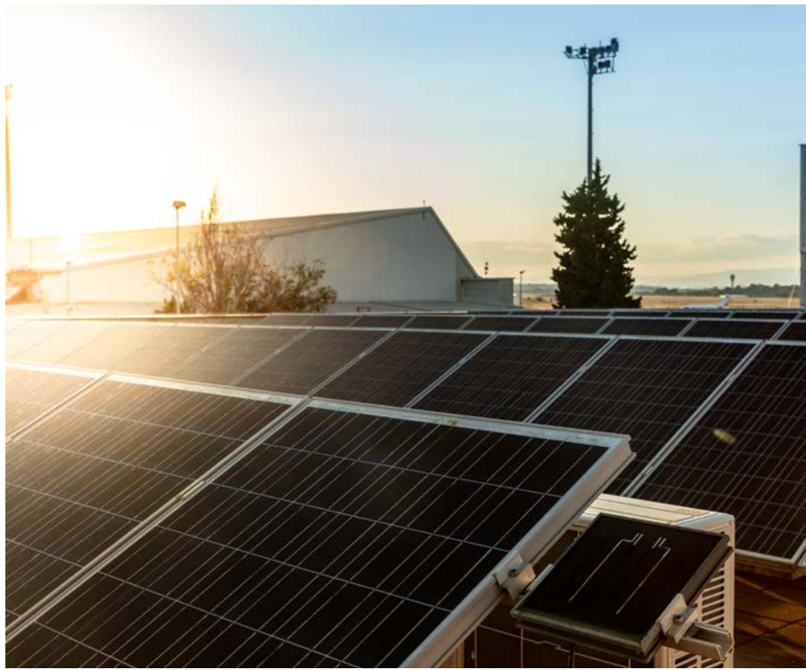
Paneles solares en Valencia.
